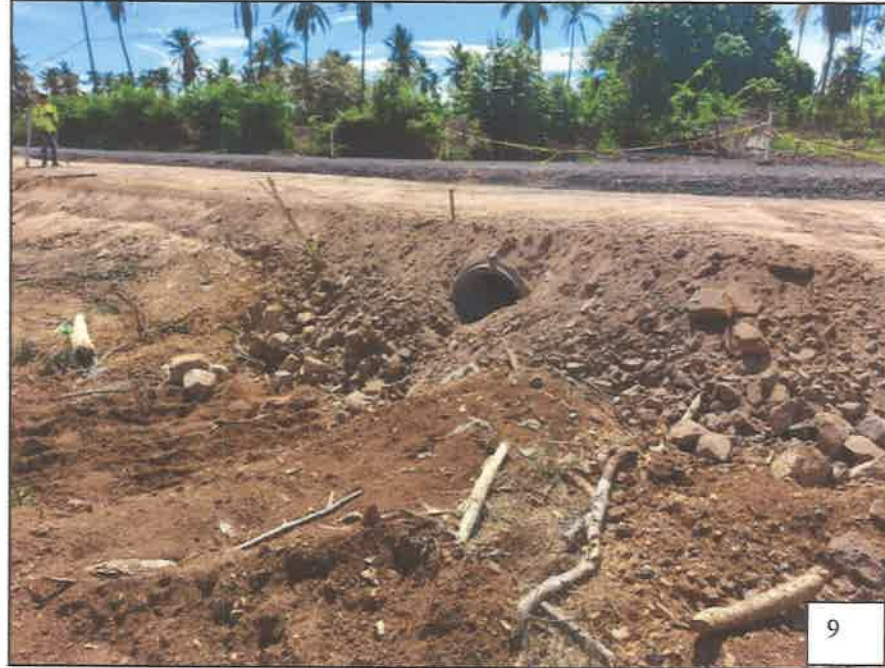
FOTOGRAFÍA 9-10: ESTACION 7K+340 TUBERIA DE 0.75 M Ø
