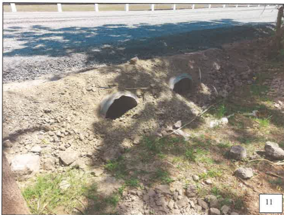
FOTOGRAFÍA 11-12: ESTACION 7K+987.50 – TUBERIA DOBLE DE 0.60 M Ø
