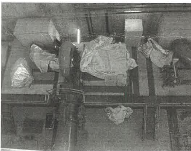
Foto N° 6. Casa de Máquina del Proyecto. En el área se ha instalado dos turbinas con especificaciones que aumentan la capacidad de producción del proyecto.
