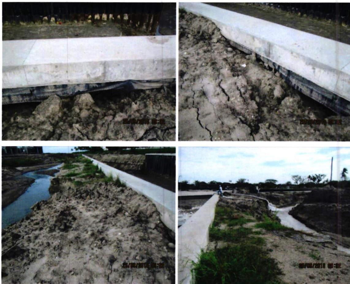
Imágenes 12 a 15. Vistas de las afectaciones a los trabajos en la marina del proyecto Agro Playa Blanca Fase II
