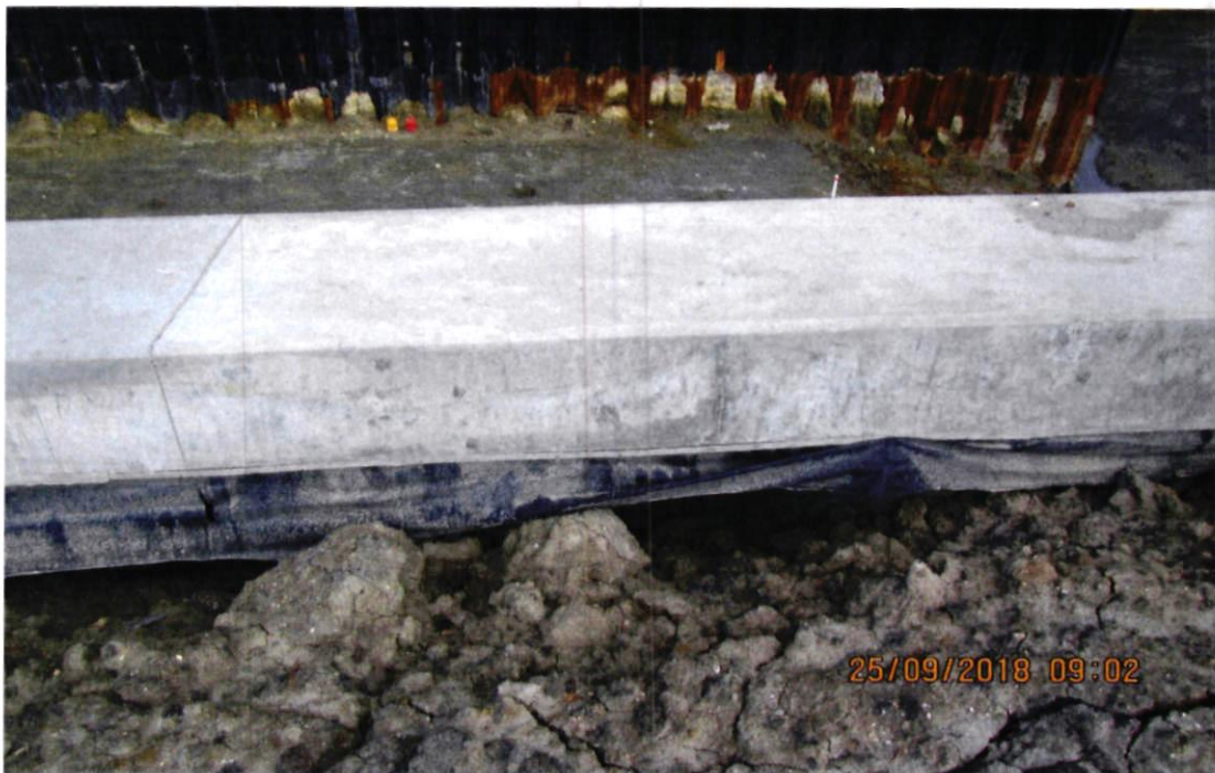
Imágenes 1 y 2. Muro afectado
