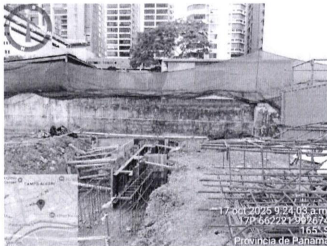
Foto 2.2 Evidencia del deterioro de la malla sarán perimetral.
