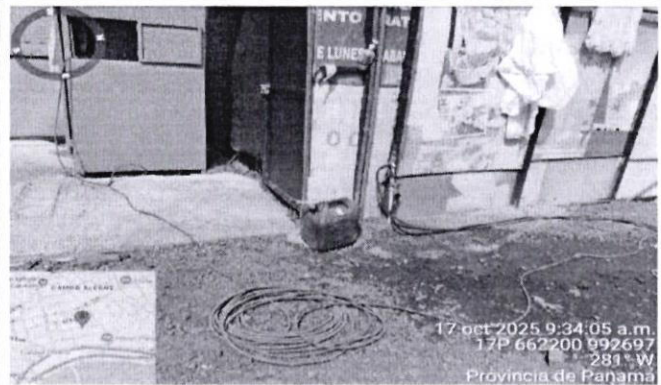
Foto 2.4 evidencia de taque de almacenamiento de combustible (pitufos), fuera del área de almacenamiento, sobre suelo desnudo.
