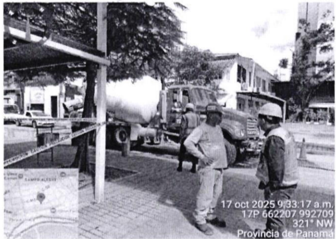
Foto 2.1 Vista de ausencia de señalizaciones de prevención y advertencia en la parte externa del proyecto
