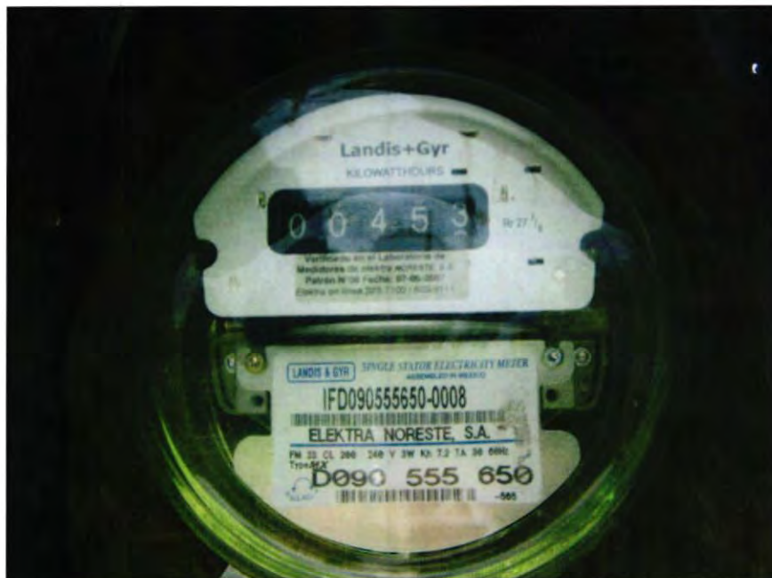
Imagen de dispositivo de registro y monitoreo de consumo de energía eléctrica (Medidor)
