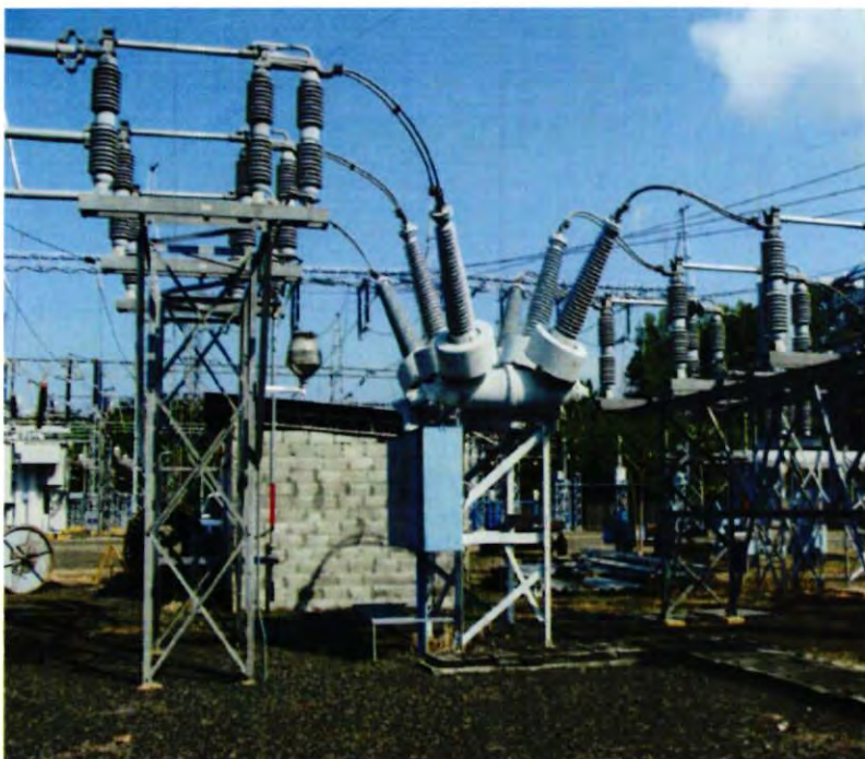
Foto N° 12. Equipos adicionales (interruptores y cuchillas)
