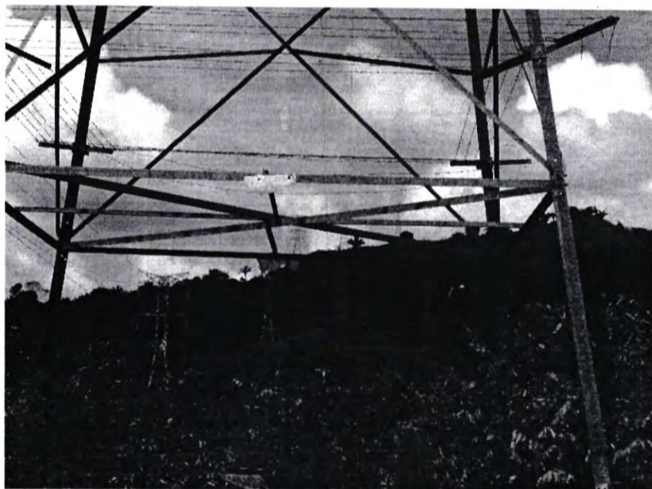
Foto N°2 Torres y líneas de transmisión ubicadas en el área de Río Chagres
