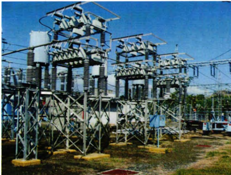
Foto N° 12. Banco de Capacitores
