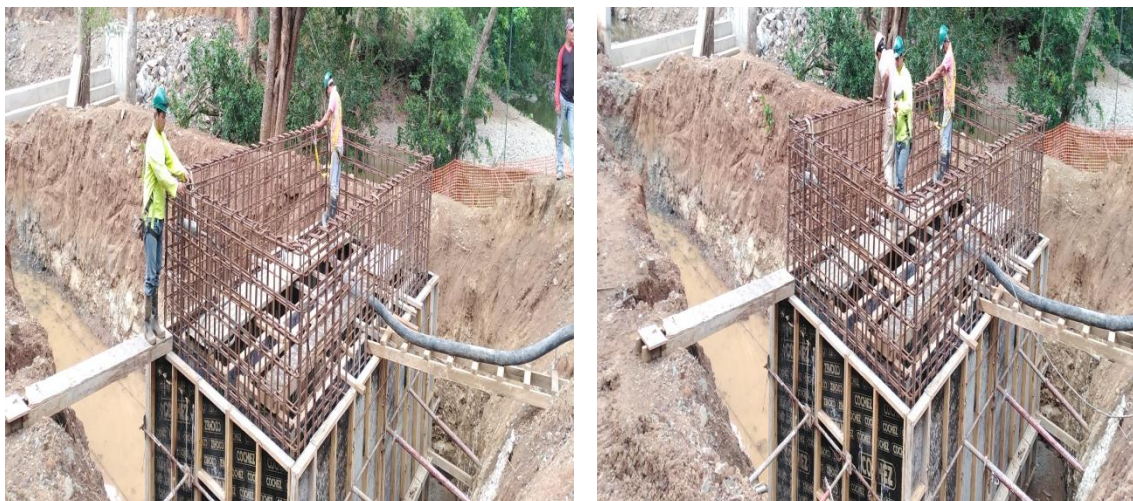
USO OBLIGATORIO DE EQUIPO DE PROTECCIÓN PERSONAL (CASCO DE SEGURIDAD, GAFAS, GUANTES Y ARNÉS DE SEGURIDAD).
