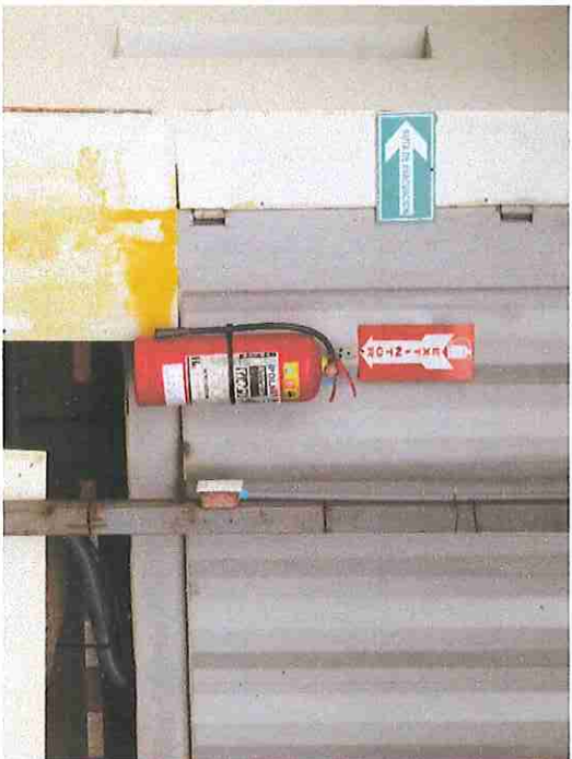
Evidencia extintores en la obra:
