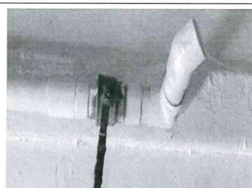
La llave de bronce se encontraba deteriorada y provocaba fuga de agua 23-4-18
