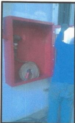
Mantenimiento de gabinetes de ciclo
