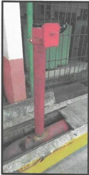
Punto de conexión de alimentación de sistema de rociadores en el taller de vapor
