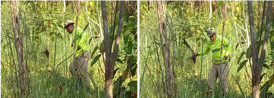
Foto No. 2. Trabajos de limpieza durante el mantenimiento.
