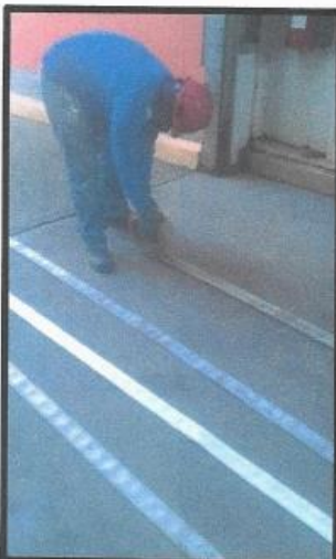
Mantenimiento de mangueras de SCI
