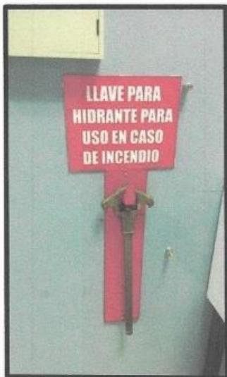
Colocacion de llaves para hidrantes en los cuartos de control. Para uso en caso de incendios.
