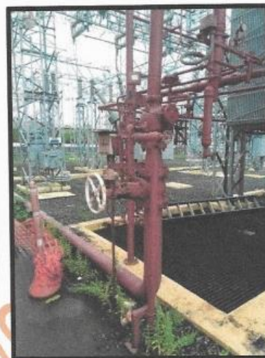
Valvula de diluvio de transformador T-12
