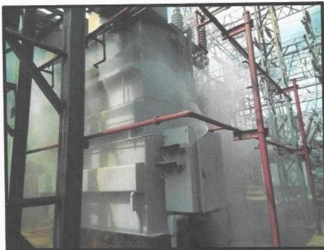
Prueba de desempeño de sistema de agua pulverizada
