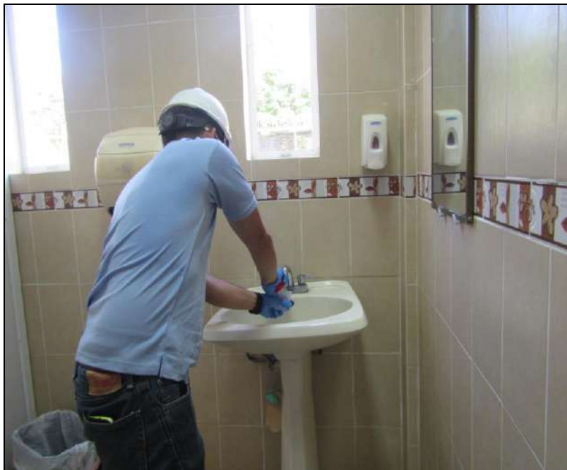
Grifo de baño de Casa Maquina.
