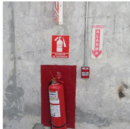
Foto 12 Extintores en buen estado y vigentes
