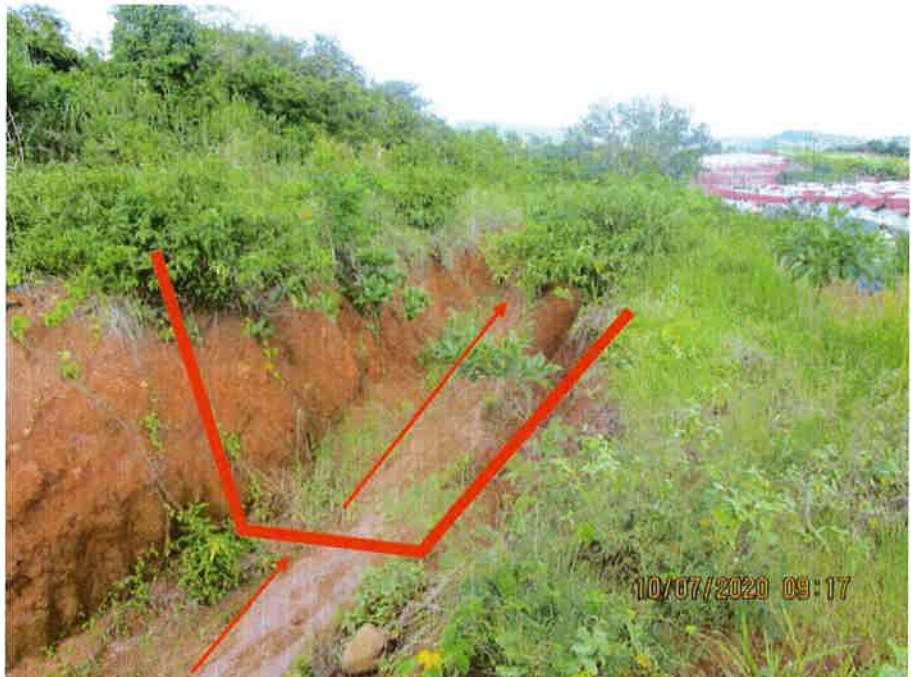
Foto 2. Canal de tierra (contorno marcado con rojo) en el cual no se visualizó agua al momento del recorrido, sin embargo, se marca con las flechas rojas la dirección que tomaría las aguas de escorrentía.
