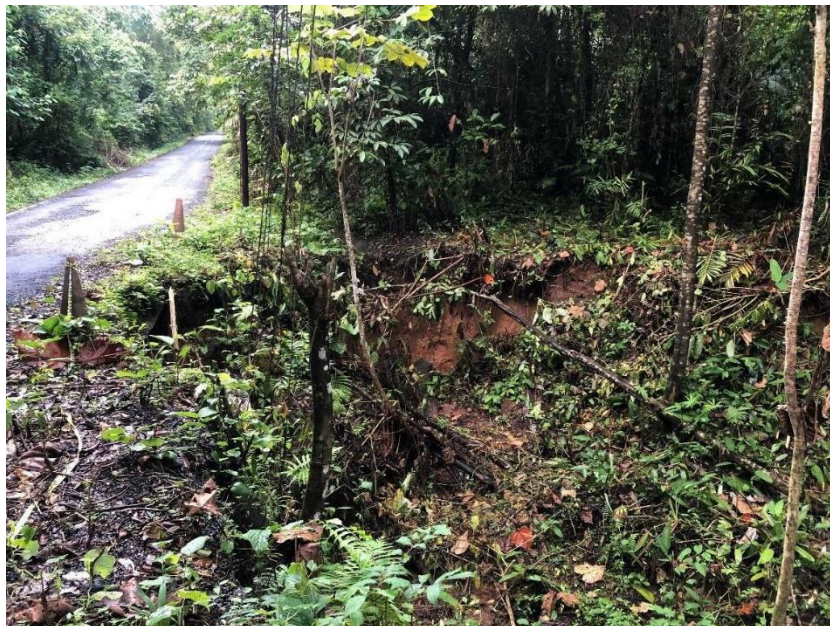
Vista de derrumbe. Punto Crítico N°1. (Estudio Puntos Críticos)
