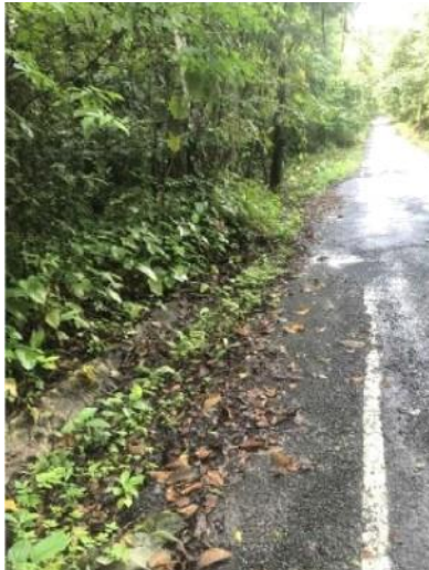
Cuneta afectada a demoler.
