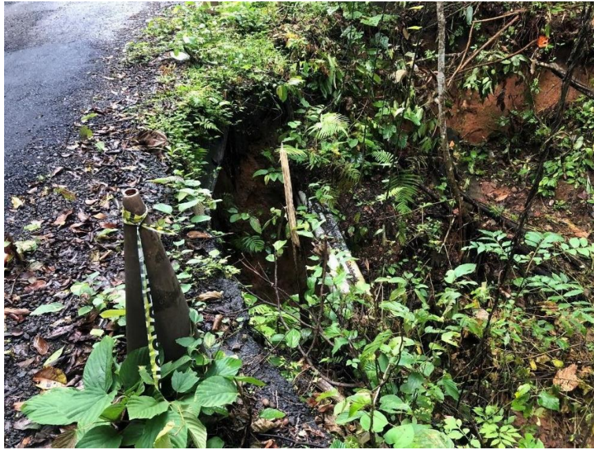
Vista de la vía con desprendimiento de la calzada. Punto Crítico N° 1. (Estudio Puntos Críticos)
