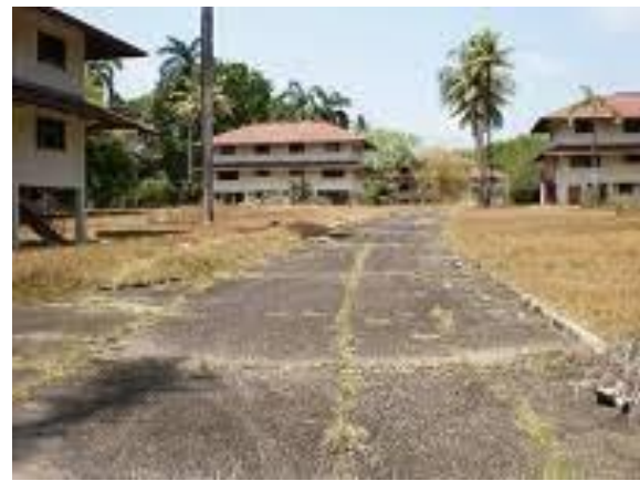
Camino de acceso deteriorado y por rehabilitar en el proyecto.
