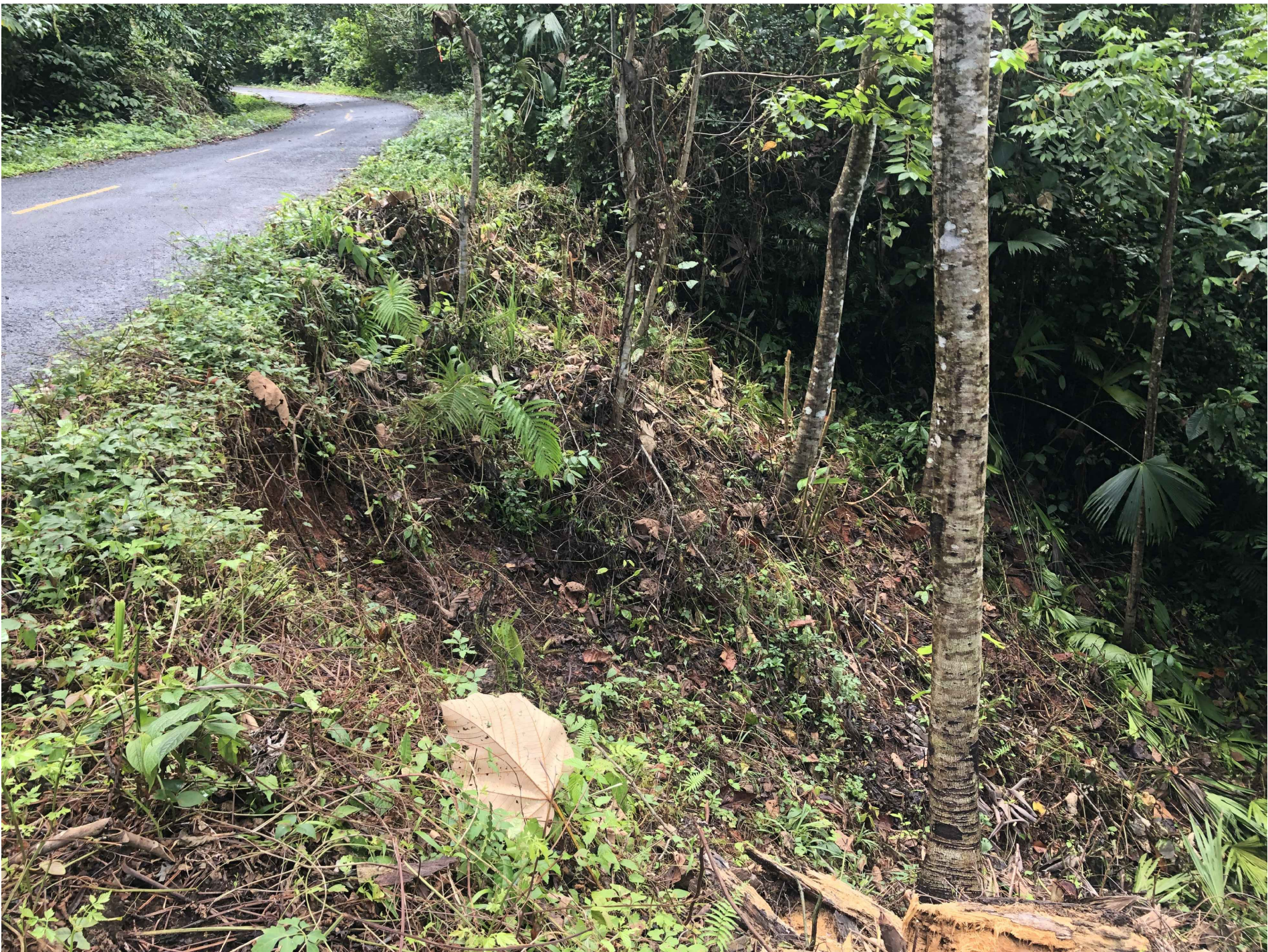
FOTO PC2 - 01. TERRENO CON DESPRENDIMIENTO
