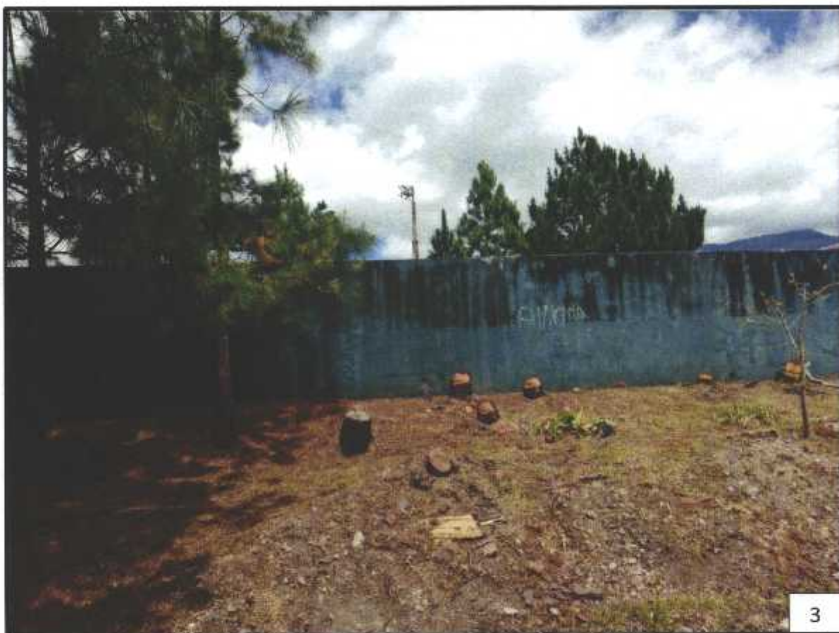
Figura 3. Vista del muro a demoler para la entrada del proyecto. Corregimiento de Alto Boquete, distrito de Boquete, provincia de Chiriquí, febrero 2021. Fuente: A. rojas.
