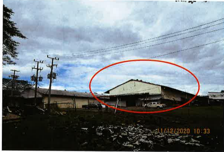
Foto 2. Área donde se construirá la nueva planta. El edificio existente será demolido.
