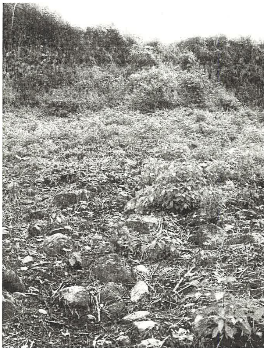
Apoyo izquierdo del cierre. Brecha antigua consolidada y reexcavada
