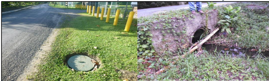
Ilustración 65 Cámaras de Inspección: Tramo La Feria – Playa Paunch
