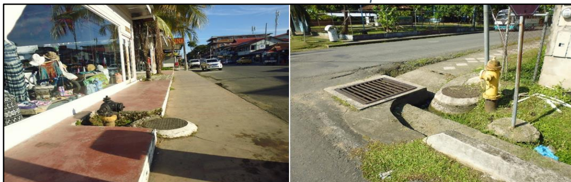
Ilustración 57 Cámaras de Inspección
