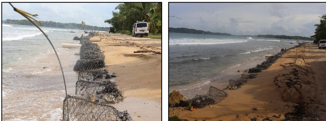
Ilustración 9. Estado de muro de gavión existente. Playa Paunch – Boca de Drago.
