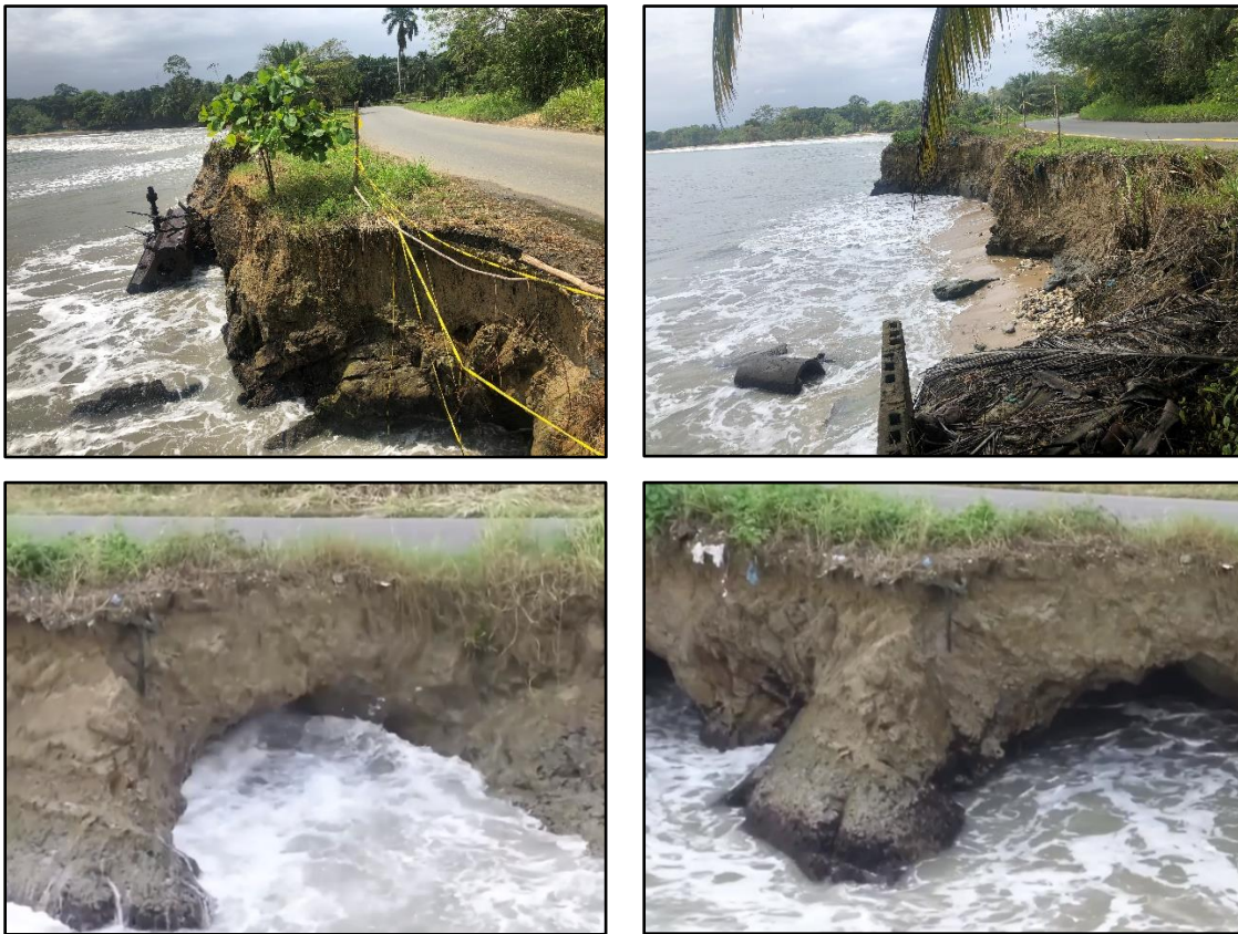
Ilustración 8. Socavación por oleaje. La Feria a Playa Paunch.
