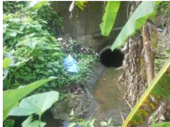
Foto N° 14: Vista general. Tramo prospectado. Zona anegada.
