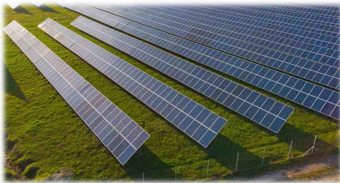
Fotografía 1 Celdas fotovoltaicas típicas
