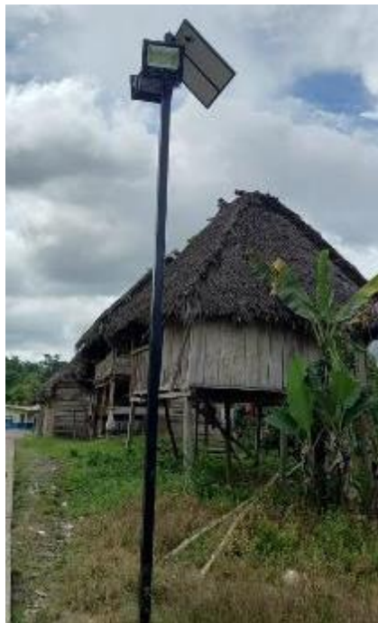
Figura 8-9. Luminarias con celda solar – Comunidad de Coclesito
