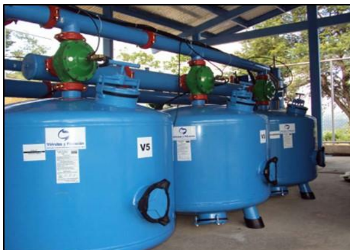
Fotografía No. 1: Filtros sedimentadores.
