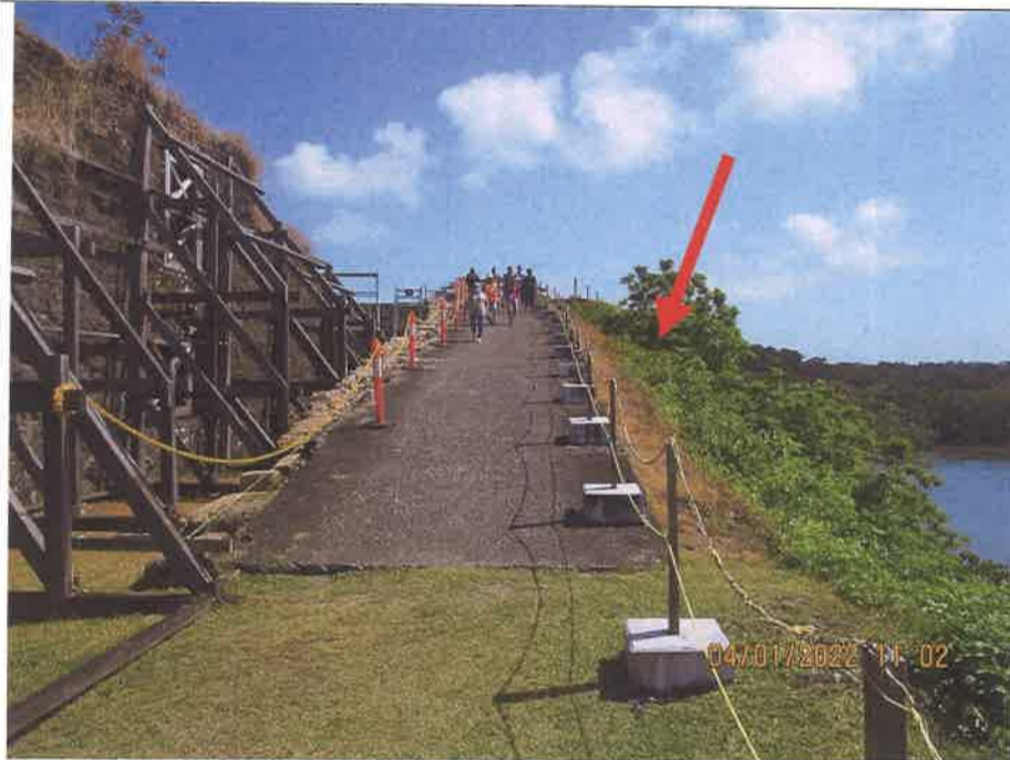
Foto 6. Ladera Sur, entre la vegetación y rampa hacia el patio de armas.
