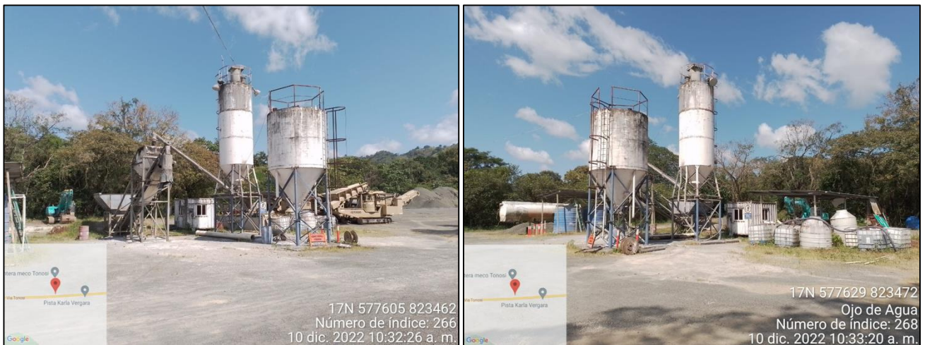
Fotografía N°12 y N°13. Se observa Planta de Concreto que será utilizada para el proyecto.
