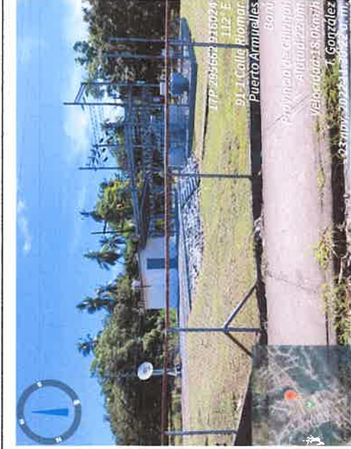
Fig. No. 3: Fotografía de la Sub Estación Puerto Armuelles; dicha fotografía fue tomada el día 23 de noviembre de 2022.
