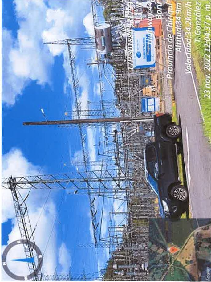
Fig. No. 2: Fotografía de la Sub Estación Progreso; dicha fotografía fue tomada el día 23 de noviembre de 2022.
