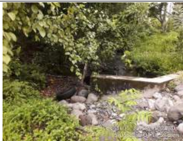
Vista de cabezal aguas abajo desde la vía existente. Presenta erosión de la vía existente, por escorrentía de lluvia.
