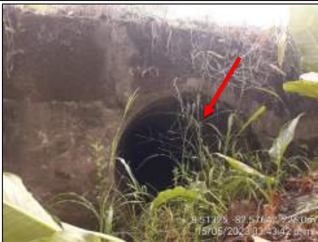
Cabezal de salida con Tubería de 1.20m Ø obstruida con sedimento y materia vegetal.
