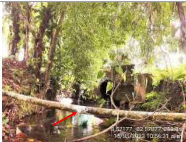
Tubería de agua potable de Ø=8 plg aguas debajo de la salida, con fuga y sin protección.
