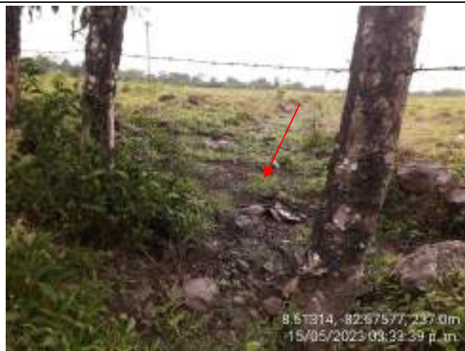
Cauce de salida presenta poca vegetación y contrapendiente para el desalojo cuando se dé la escorrentía.
