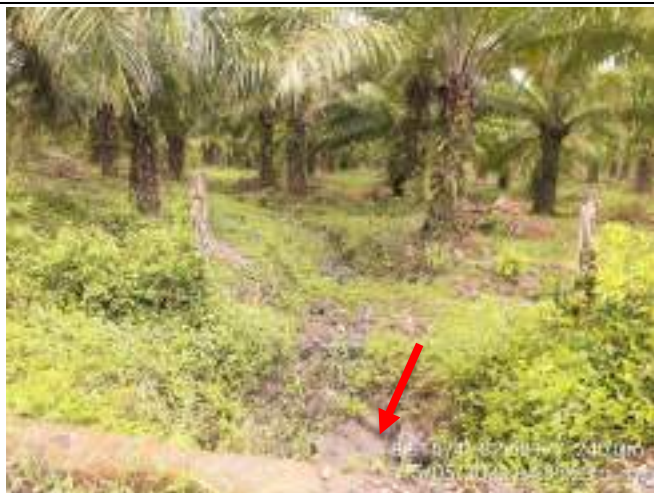
Vegetación y cauce aguas abajo del cabezal de salida de tuberías. Se aprecia hoyo en el cauce, a la salida de la tubería.
