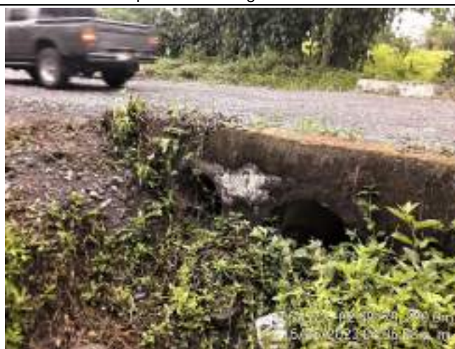
Vista Salida de tuberías de 0.60m Ø y cabezal de concreto. Se aprecia obstrucción parcial y falta de mantenimiento de dicho cruce.
