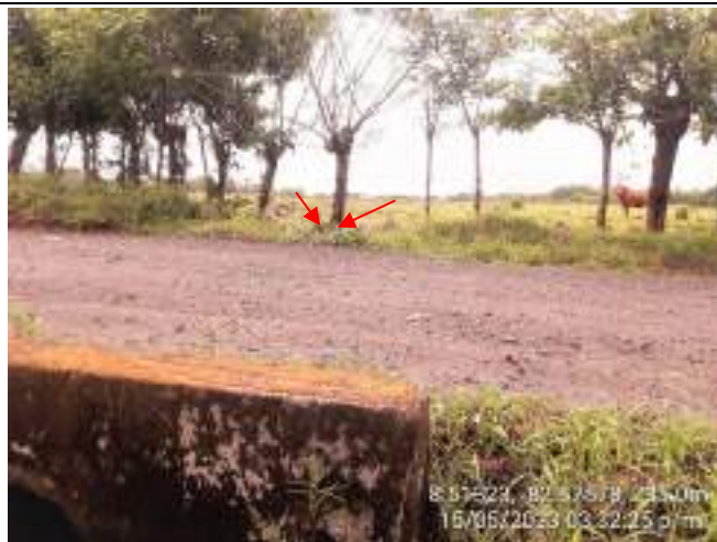
Vista desde cabezal de entrada hacia aguas abajo, se visualiza una contra pendiente en el cauce de salida.
