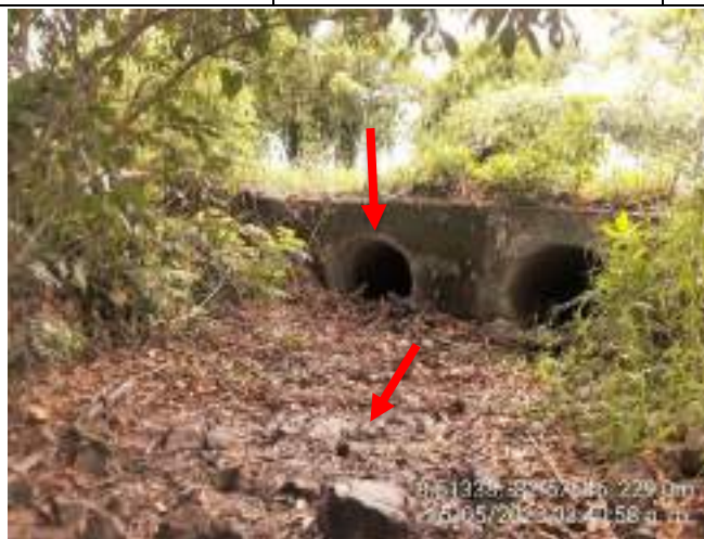
Vista de cabezal de entrada y tuberías de 1.20m Ø de concreto. Obstrucción en tubería izquierda, no se presenta agua como escorrentía, pero si humedad en la tierra.
