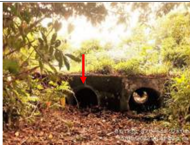
Vista de cabezal y tuberías de entrada de 1.20m Ø de concreto. Ancho de sección de 6.0m y obstrucción en tubería izquierda.
