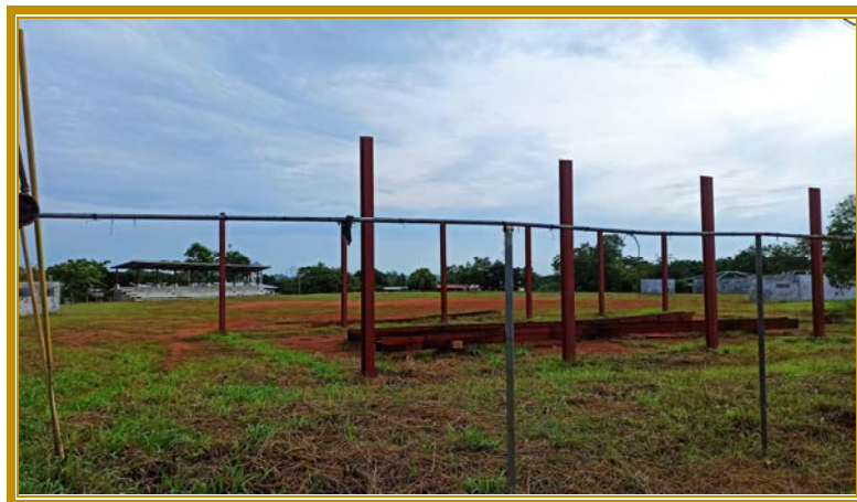
Imagen #117 Estadio de Macaracas obra sin culminar.
