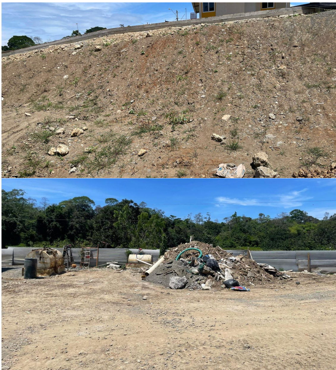
Fig. 6.- Otras vistas del proyecto, los taludes se inspeccionaron con resultados negativos
