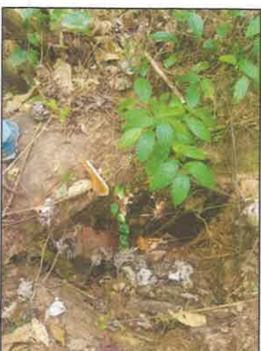
Foto nº3: Punto donde convergen las aguas de escorrentías procedentes de la parte alta
