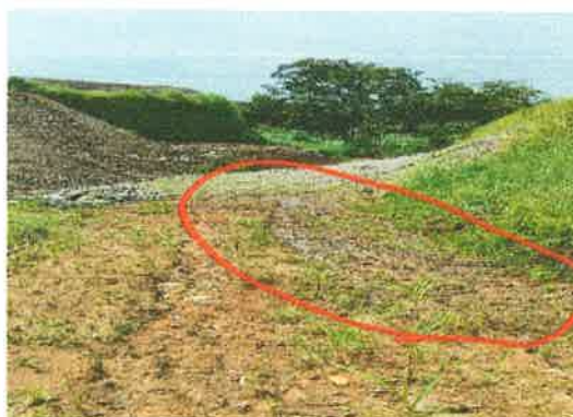
Se observa filtración de agua
