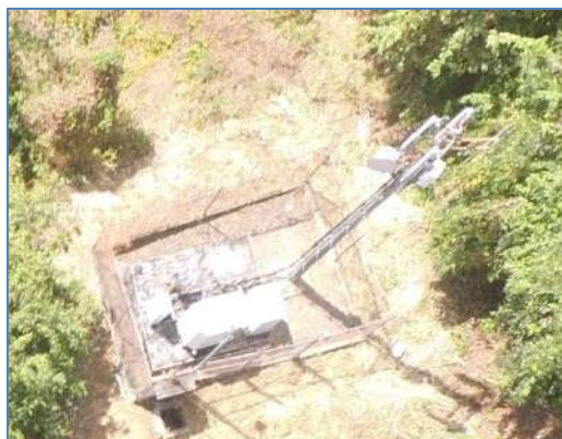
Figura 14. Antena de telefonía Celular
