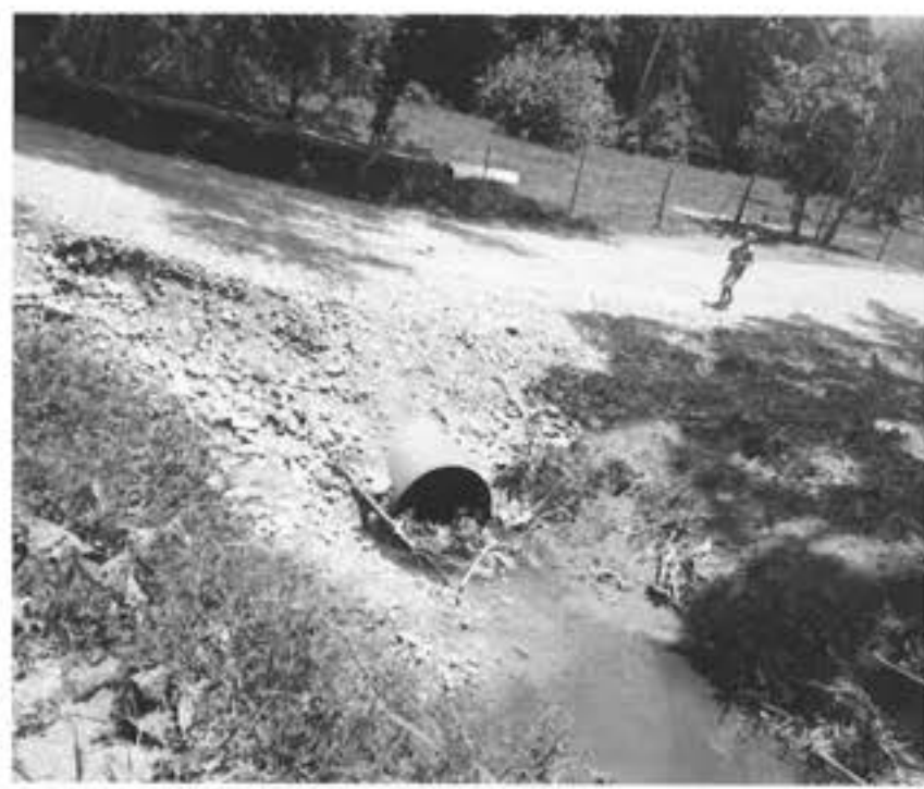
Figura 6. Se aprecia alcantarilla, rellena de tosca, la cual es utilizada como vía de acceso por los moradores de la comunidad de Quebrada Banano 1. Coordenada: WGS-84 17 p_ 340751.00 m E_ 1034278.00 m N.
