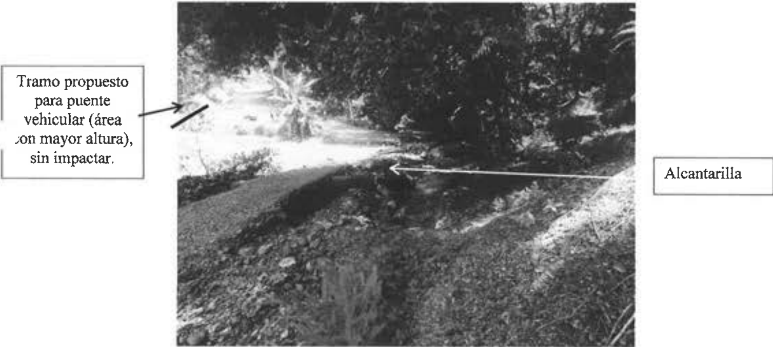
Figura 5. Se aprecia alcantarilla, rellena de tosca, la cual es utilizada como vía de acceso por los moradores de la comunidad de Nueva Visión. La Quebrada bordea la calle y en un tramo se aprecia que la fuente hídrica pasa sobre la calle. Coordenada: WGS-84 17 p_ 343011.05 m E_ 1024427.99 m N.
